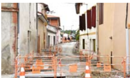
Les réseaux rue de Pétricou
